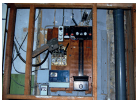
Eltavle kan indeholde relæer og andet elektrisk udstyr, der kan indeholde PCB og kviksvølv.
