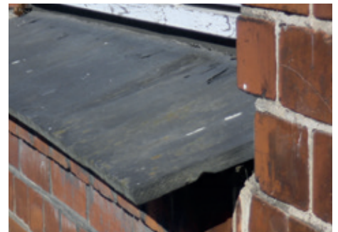
Sålbænk – kan indeholde asbest. Hvis der er usikkerhed om indholdet af asbest, skal materialerne håndteres, som om de indeholder asbest. Ved større mængder skal der foretages analyse.
