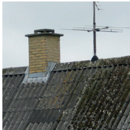
Ældre eternittage indeholder som oftest asbest.
