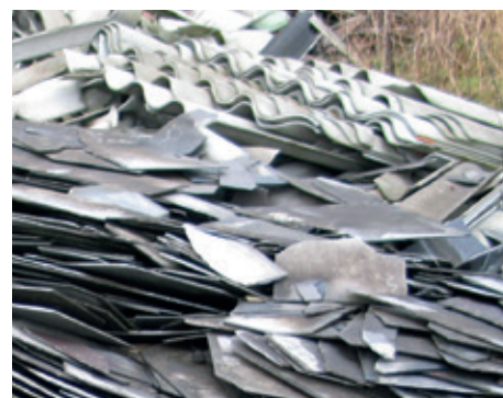
Affald af eternitplader oplagret i strid med reglerne. Eternitplader skal tages hele ned og må ikke beskadiges, da de afgiver farlige asbestfibre. Beskadigede plader skal være forsvarligt emballerede i støvtæt emballage.
