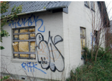
Konddemneret hus malet med blyholdig murlæmning. Før nedrivning skal malingen renses af og opsamles for korrekt bortskaffelse.
