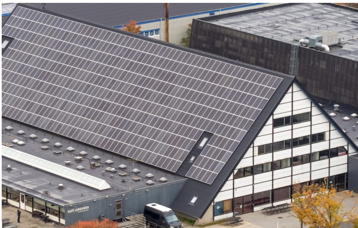
Solceller på Greve Idrætscenter
