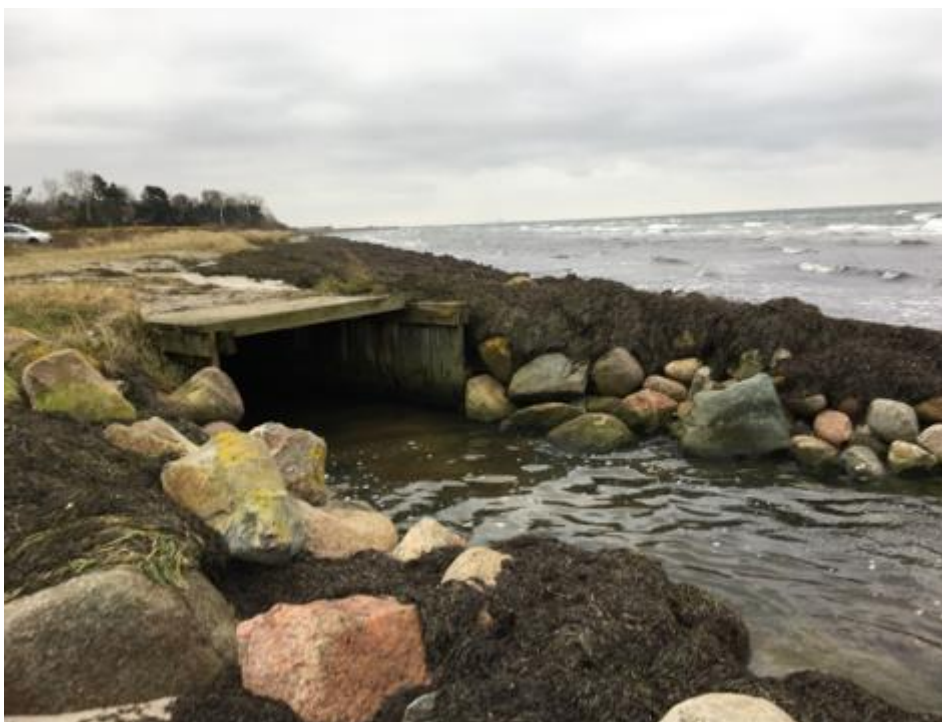
Figur 20: Udløb fra pumpestation
