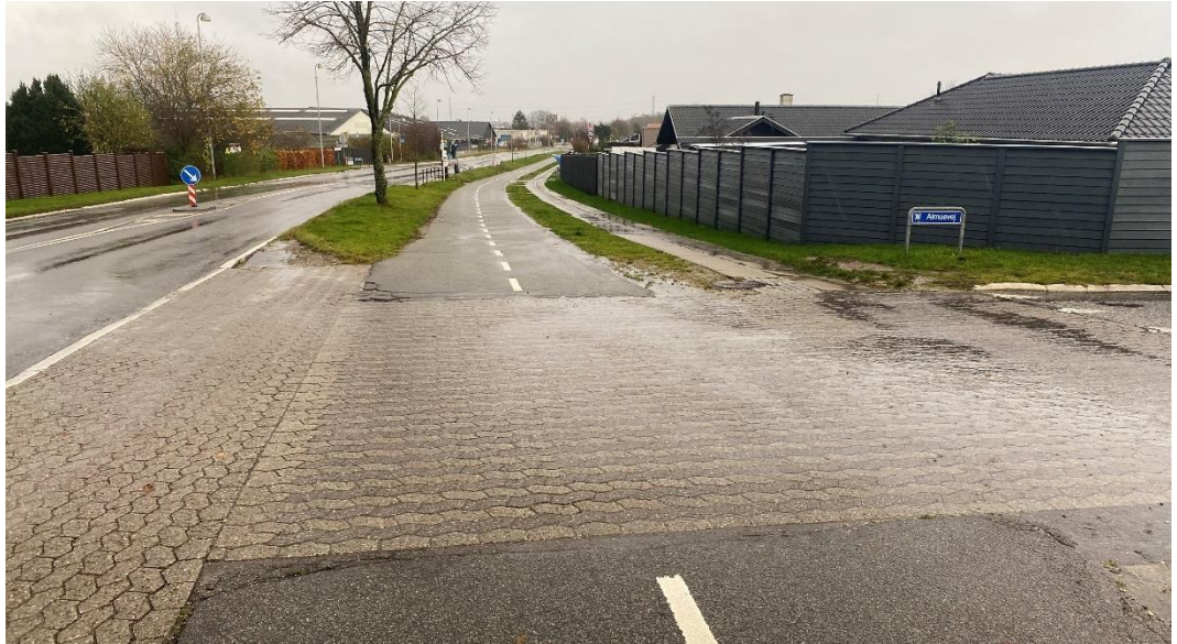
Figur 7. Ind- og udkørsel ved Almuevej, hvor den ændrede belægning skaber opmærksomhed, men samtidig stadig en uklar indikation af prioriteringsforholdene. Desuden gør stakittet og de langt tilbagetrukkede hjænder, at det kan være svært at skabe oversigt mod øst.
