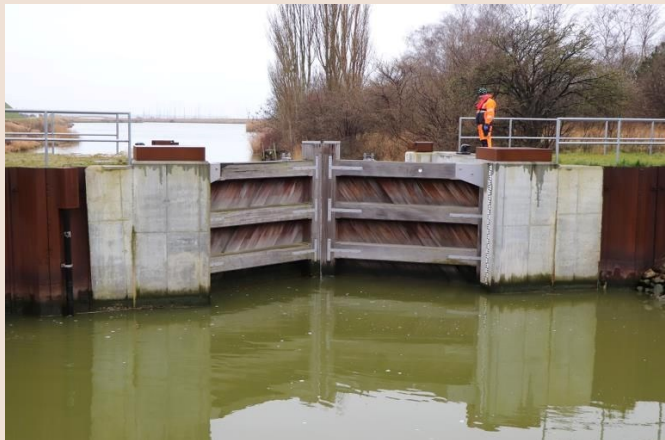
Højvandsport med pumper i Frederiksværk
